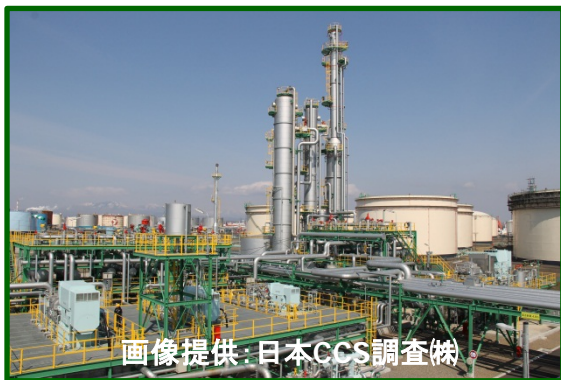
苫小牧CCS実証プロジェクト地上設備
